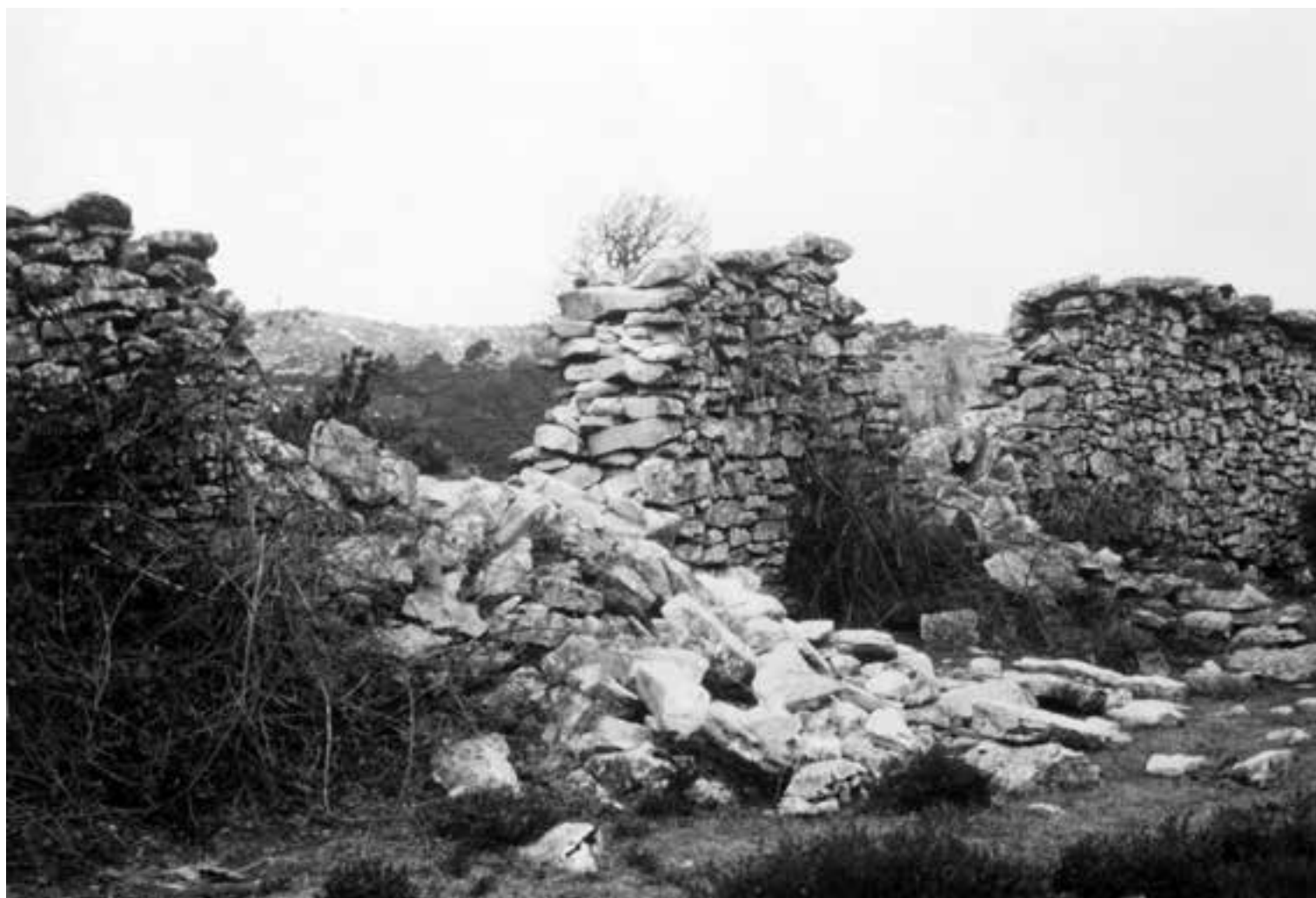
Las paredes de la loba de Barrón están semiderruidas
